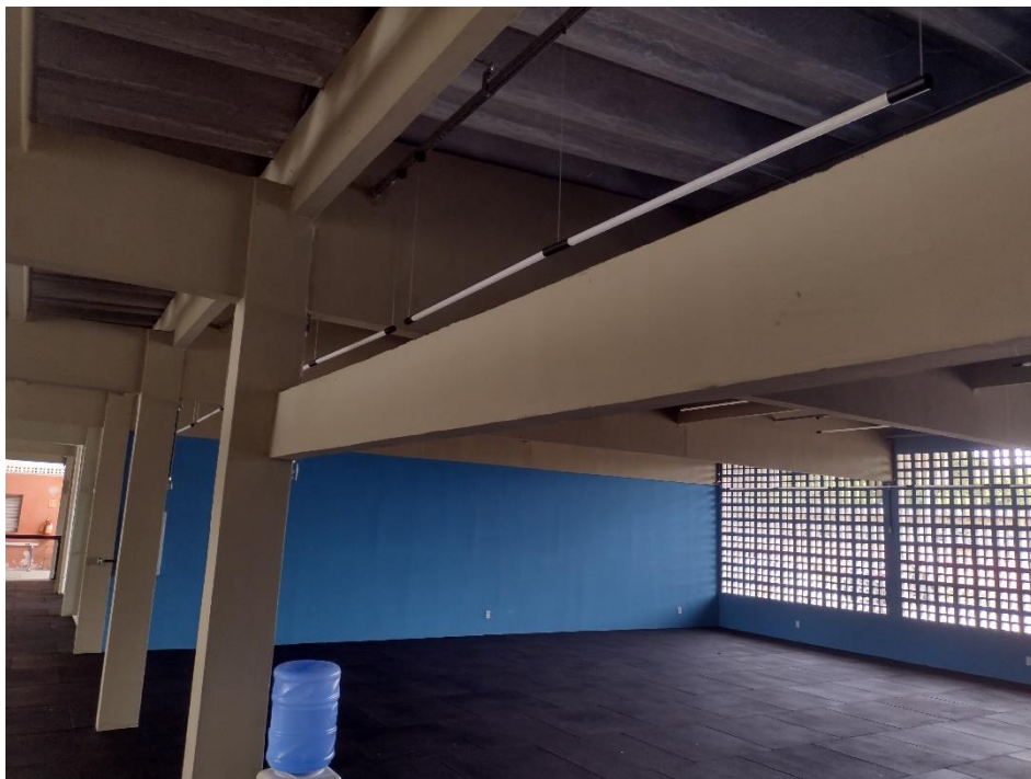
Figura 4 – Luminárias. Área Crossfit . Concluída.
