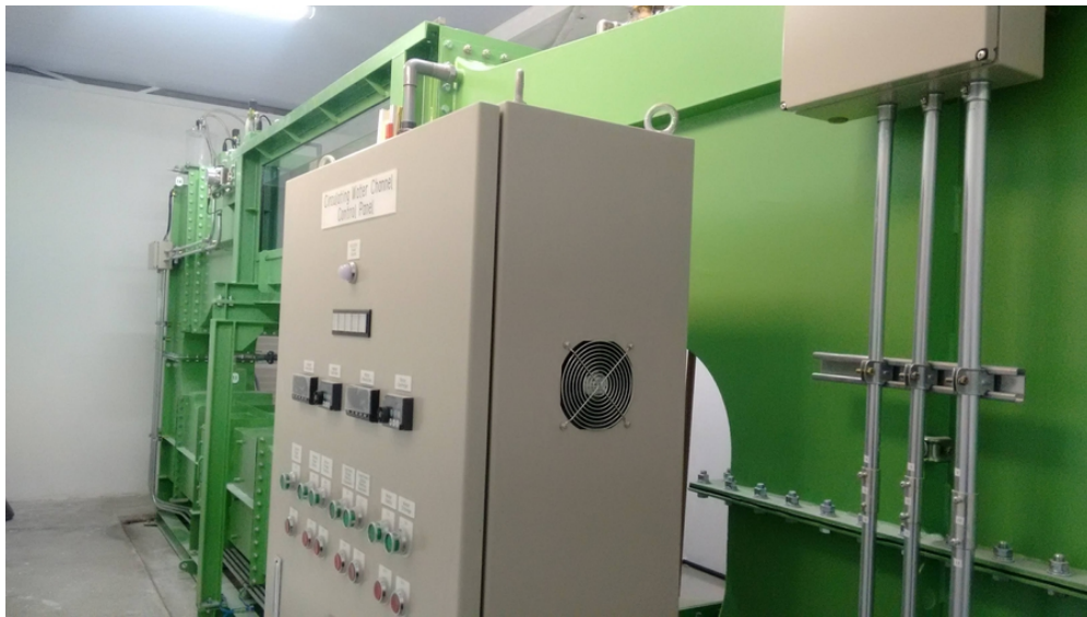
Figura 4 – Visão global do CWC instalado no LAB3C
